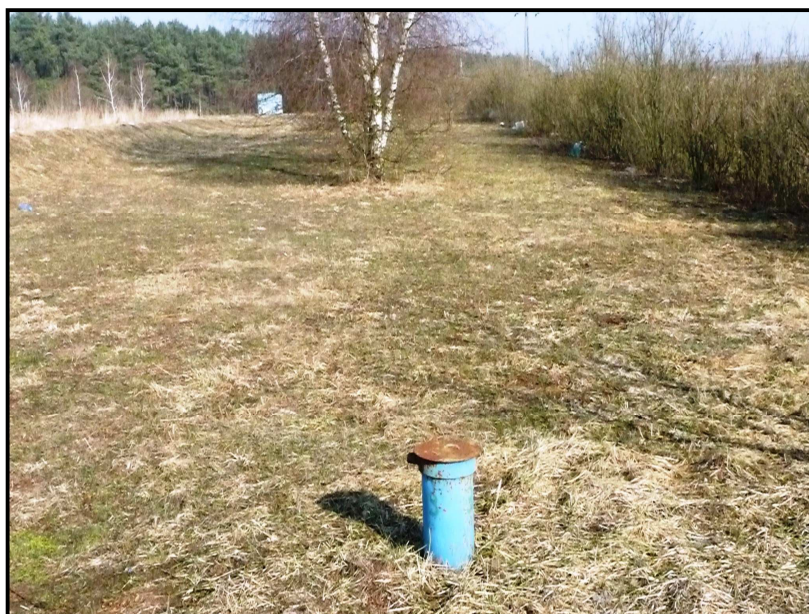
Fotografia nr 9 Monitoring wód podziemnych – piezometr P3 zlokalizowany na odpływie wód gruntowych (01.III.2011r).
