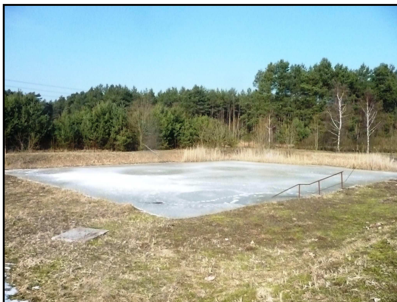
Fotografia nr 7 Zbiornik na odcieki (01.III.2011r.)
